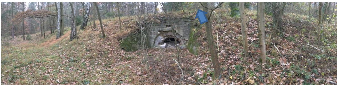
Obr.75 Pohled na násep koněšpřežné železnice od jihu, uprostřed zborcená klenba propusti
