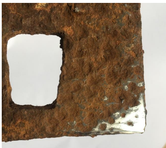
Obr.84 Vybroušený roh podkladové desky
