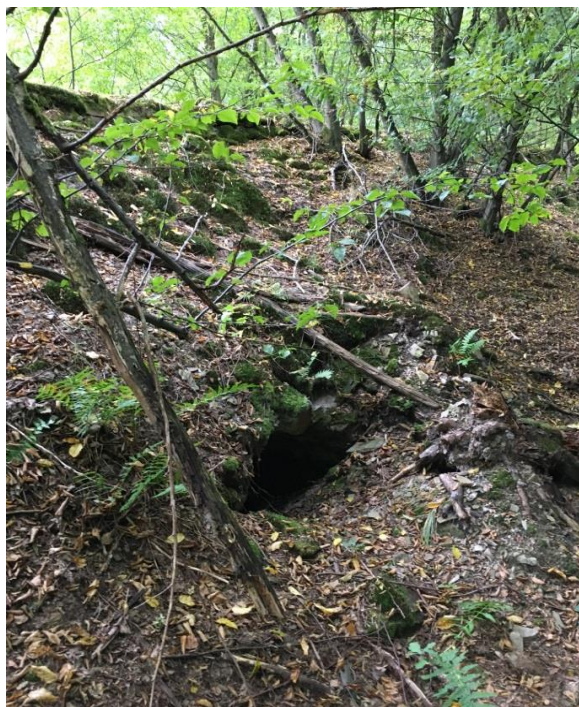
Obr.133 Zával propusti pod kamenným náspem
