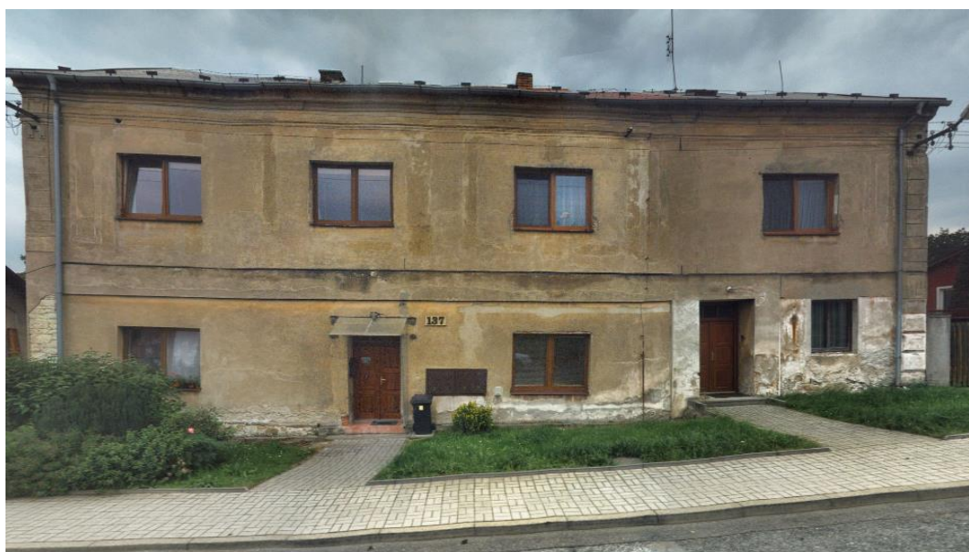
Obr.199 Rynholec Pražská ulice čp. 137 „ Stará štace“ ( též štací, přejato ze slova Station) zeměpisné souřadnice 50°08'19.742" N 13°55'48.8512" E , snímek je z května 2021
