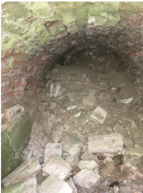
Obr. 285 Zřícený kamenný obklad klenby
