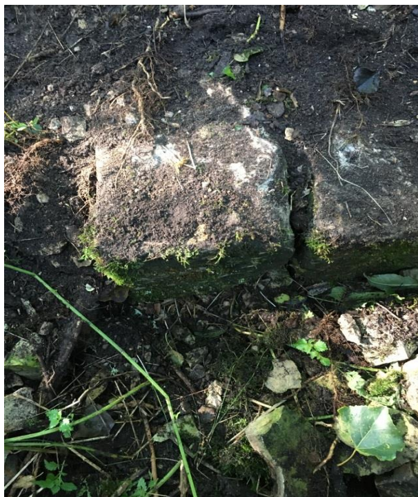
Obr. 246 Zbytky zděné opěry mostu přes náhon
