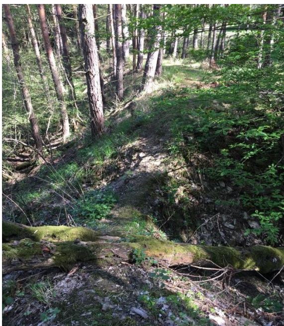
Obr.148 Zřícená propust náspu v lese u Píně
