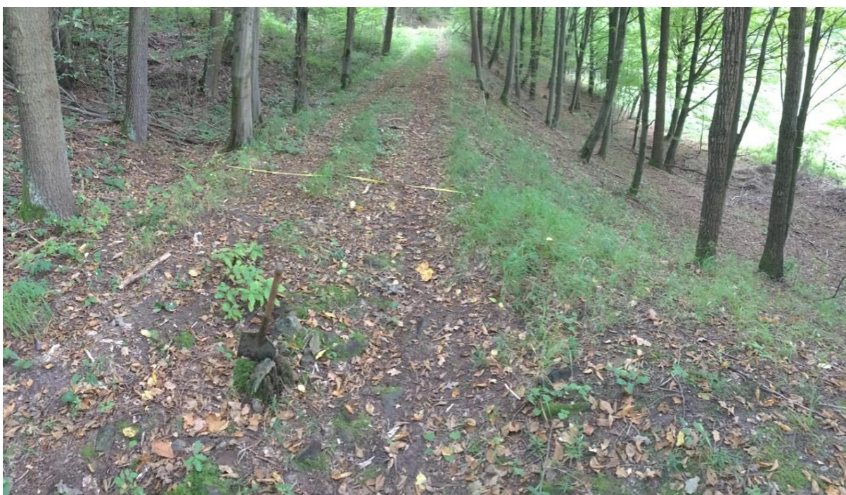
Obr.125 Šíře náspu v koruně je cca 2,8 metru – poblíž křížení s turistickou stezkou značenou zeleně
