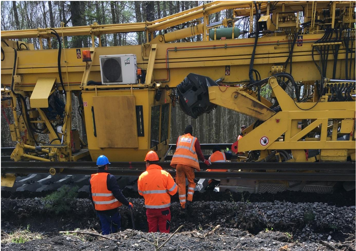
Obr.496 Stroj provádějící výměnu pražců, na snímku je detail manipulátoru k vkládání nových pražců
