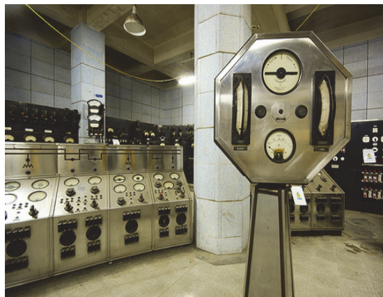
Obr.59 Velín tepelné elektrárny
