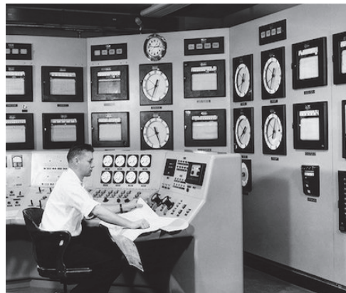
Obr.61 Velín tepelné elektrárny
